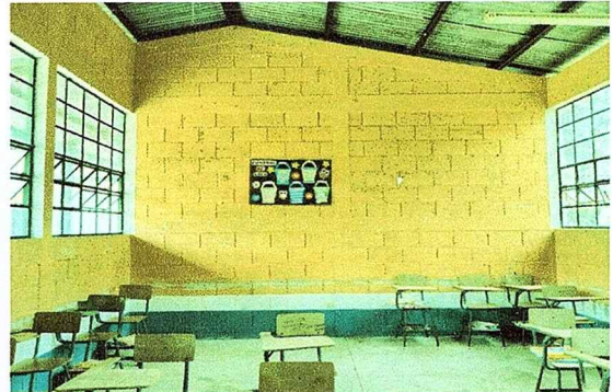
FOTO 2: La pintura de la pared se encuentra en deterioro
