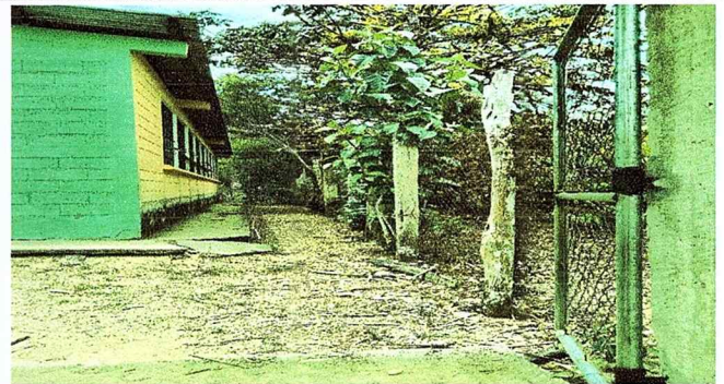
FOTO 6: Postes y mallas en malas condiciones
